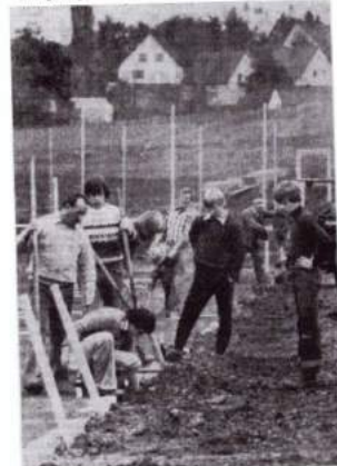
JUGENDLICHE, Senioren- und Alt-Herrenfußballer beteiligten sich in Lindlar an freiwilligen Arbeitsstunden am neuen Sportplatz. Über 30 Akteure waren am Samstag im Einsatz.
